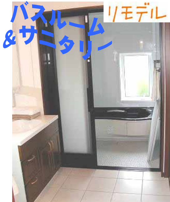
風呂のリモデル リモデルは脱衣所側から施工 バスルームと脱衣所は一緒にリモデルしよう！
